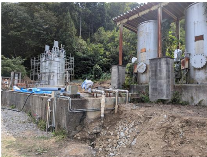
施設の更新 一里野簡易水道（急速ろ過装置等）
