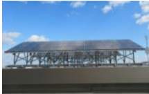
太陽光パネル
