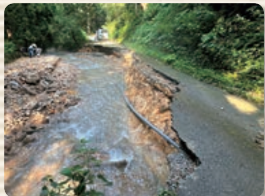
8月豪雨で被災した林道
