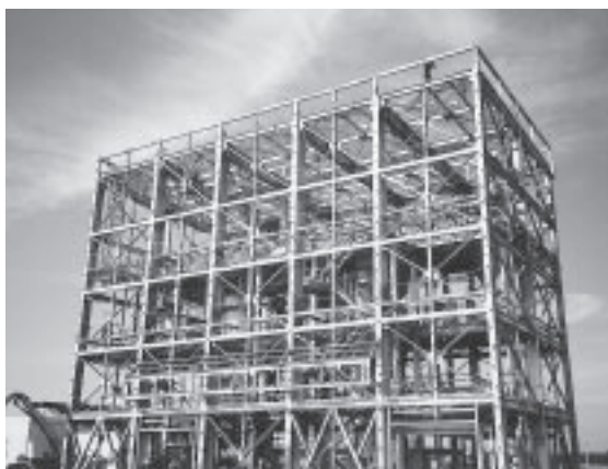
処理能力が増強される松任中央浄化センター
