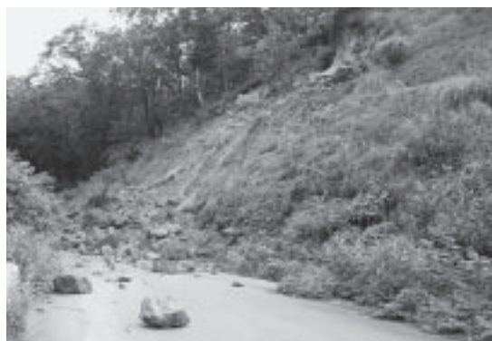
白木峠線災害被災箇所(白峰地区)
