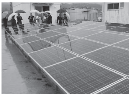
公民館の屋上に設置された太陽光パネル（飯田市）
