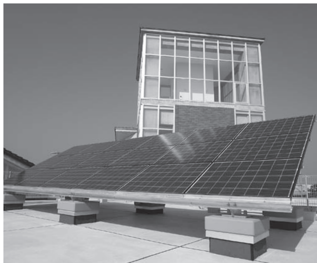
環境教育の一環として美川小学校に設置された太陽光パネル
