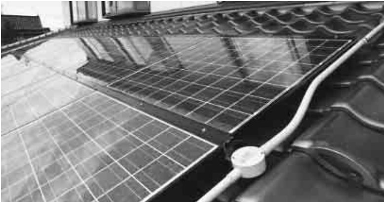
市内住宅に設置されている太陽光発電システム
