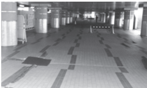
液状化で路面に被害が残る舞浜駅（浦安市）
