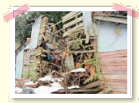
倒壊の恐れがある空き家
