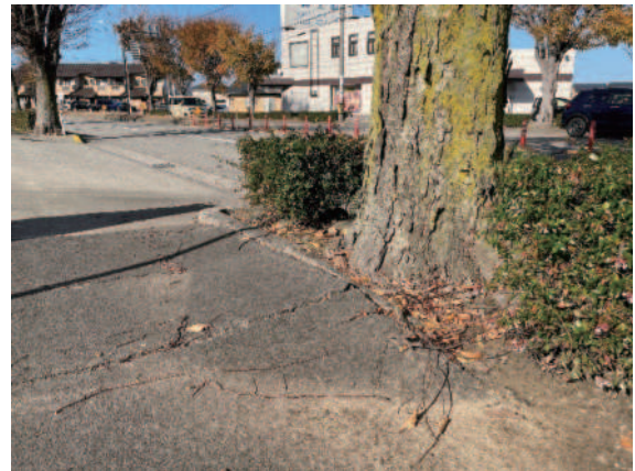
【根上がりが生じている街路樹】
