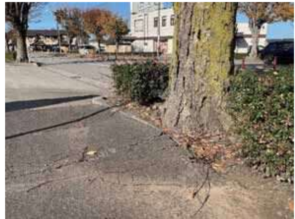
【根上がりが生じている街路樹】
