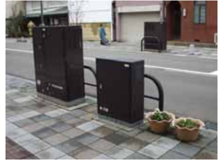
沿道に地上機器を設置 (千代尼通り)
