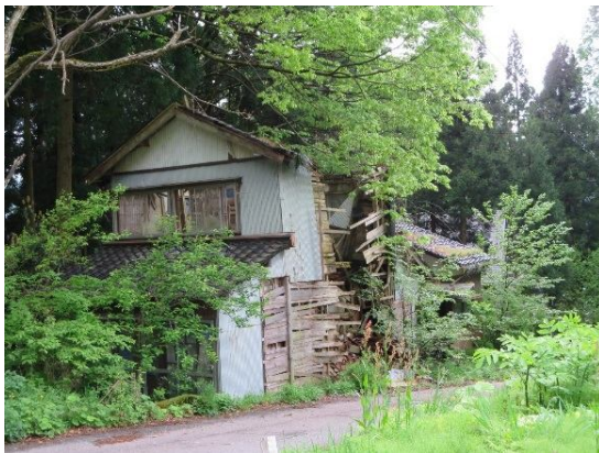
解体前：屋根が崩落し危険な状態
