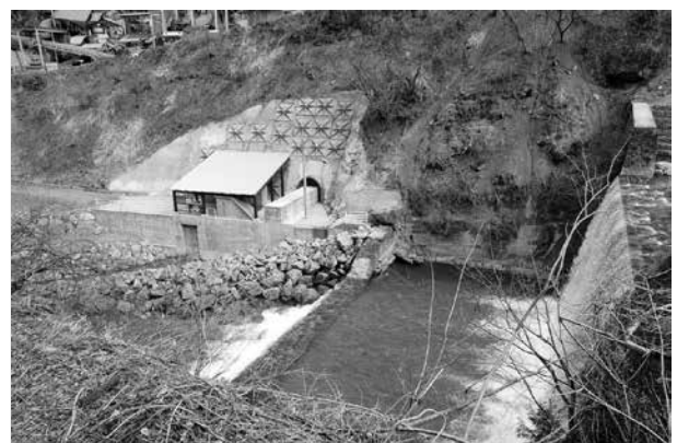
小水力発電所
