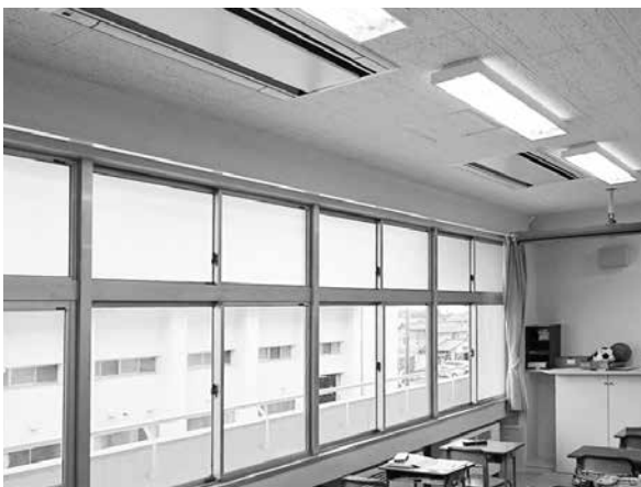
教室に設置したエアコン
