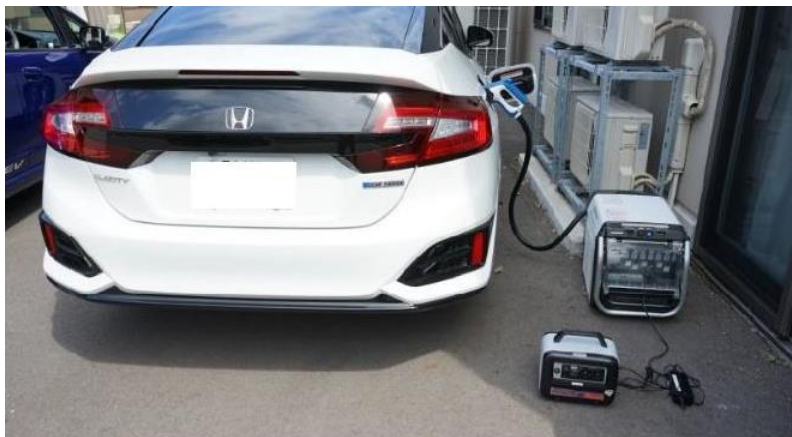
(FCV からの給電：老人ホームでエアコンや小型蓄電池の充電に使用)
