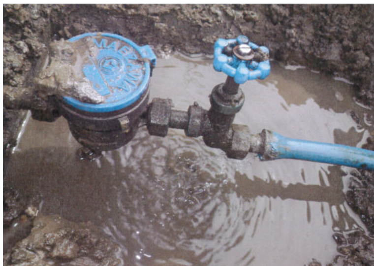
図：鉛管からの漏水
